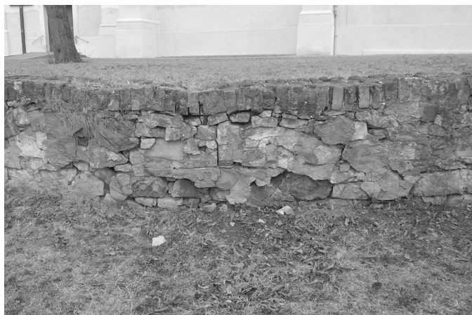
Havarijní stav kostelní zdi
