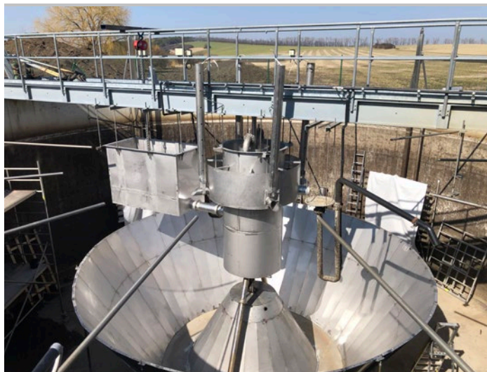
Dosazovací nádrž ČOV
